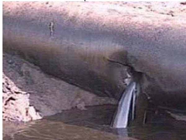
Рисунок 74 - Авария на нефтепроводе
